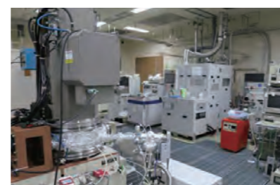
先端技術共同研究施設のクリーンルーム Clean room of the facility
