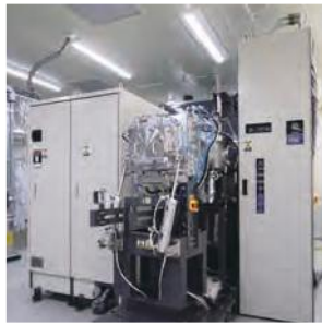
イオン注入装置 ULVAC IMX-3500 Ion implanter ULVAC IMX-3500
