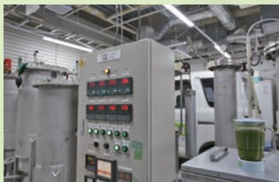
バイオガス発電システム
