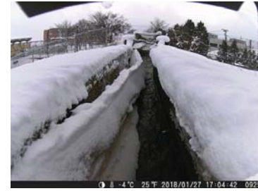
図6 右岸の開水路壁への着雪 (図5から53時間後)
